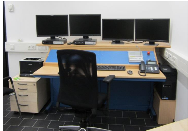
Leitstand der Atemschutzübungsanlage
