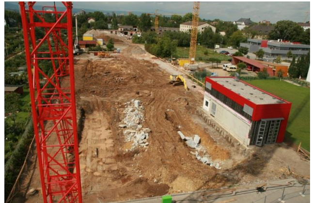
Das Anfang August 2011 gemachte Foto zeigt die gewaltige Dimension der Baustelle – sie erstreckt sich schlauchförmig bis an den Grünstreifen am oberen Bildrand
