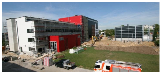
Baustellenblick Ende August 2012: links das Hauptgebäude mit dahinter angrenzender Übungshalle, rechts die Realbrandhalle
