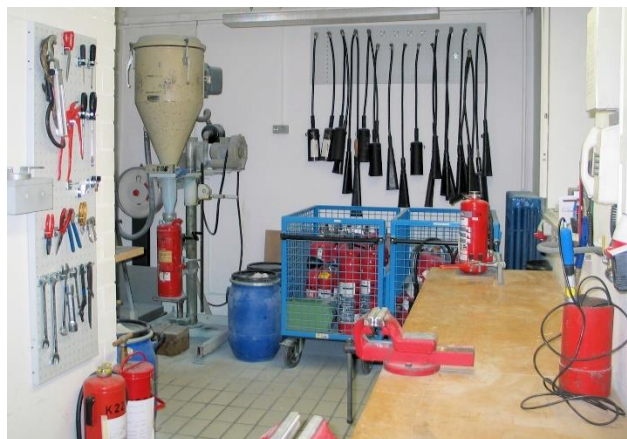
Die neue Feuerlöscherwerkstatt
