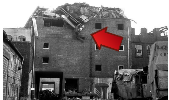
Aufzugsmaschine droht abzustürzen.
